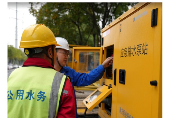
工程与工地排水
